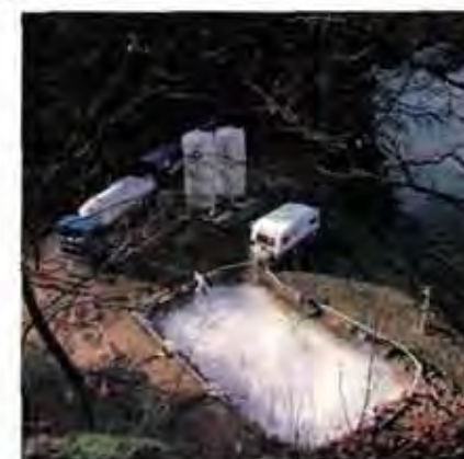
Tankfahrzeuge und ein Speicherbehälter vor Ort sichern den Nachschub des tiefkalten Gases für die Baugrube
