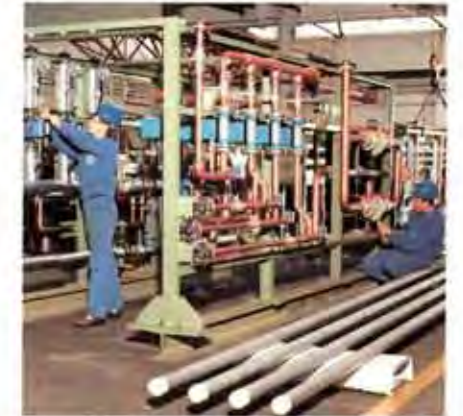
Unser Beitrag zum leistungsstarken Kupferschmelzverfahren Contop: Sauerstoffbrenner und Dosierstationen
