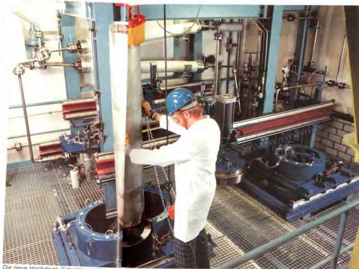
Die neue Hochdruck-Extraktionsanlage arbeitet gassparend mit zwei Druckbehältern, die im Wechsel beschickt werden
